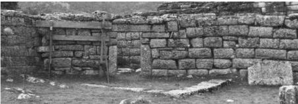
Abb. 38 Dodona. Ansicht des inneren Mauerrings im westlichen Teil des Skenengebäudes. Zustand im Sommer 2005.
