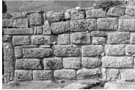
Abb. 40 Dodona. Ansicht des nördlichen Abschnitts des inneren Mauerrings im westlichen Teil des Skenegebäudes. Zustand im Frühjahr 2012.
